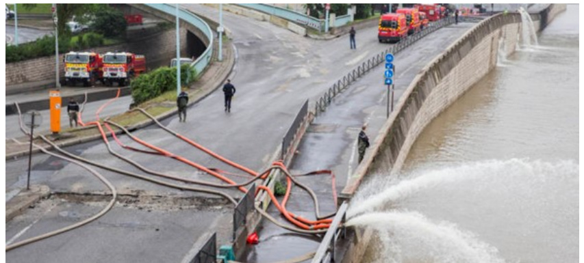
Crue de la Seine et opérations de pompage, juin 2016
